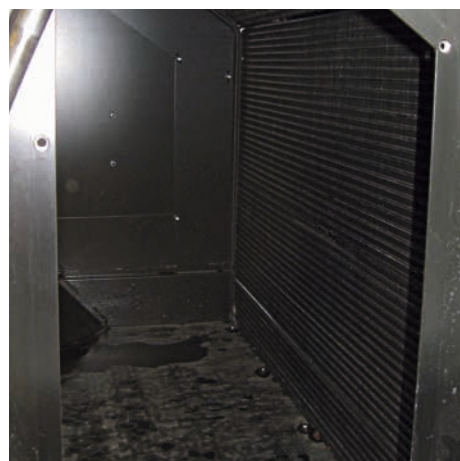
Radiatori ben accessibili per le operazioni di pulizia.
