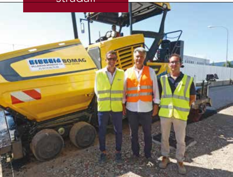
4. Da sinistra l'Ing. Paolo Giuggia che - insieme ai fratelli - prosegue l'attività familiare, Paolo Giacompol, Titolare del Concessionario Bomag S.L.I.M. di Genova e l'Ing. Marco Castellino, Responsabile delle opere stradali di Giuggia Costruzioni Srl
