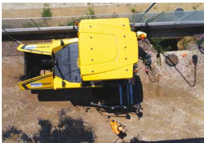
7. La Bomag BF 600 è in grado di muoversi agevolmente sia nei grandi cantieri che negli spazi più ridotti delle classiche opere di urbanizzazione a corredo delle costruzioni edili
