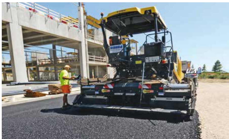
6. La stesa dello strato di fondazione è stata rapida e uniforme anche nelle condizioni logistiche complesse di un cantiere come quello in cui la macchina è entrata in azione
